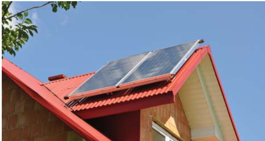
Kolektory słoneczne zamontowane na budynkach mieszkalnych w gminie Biłgoraj
